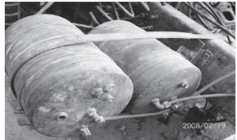
图一 制动储气罐未接管路
